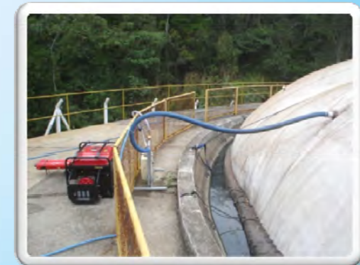
ETE Jambeiro - SP
