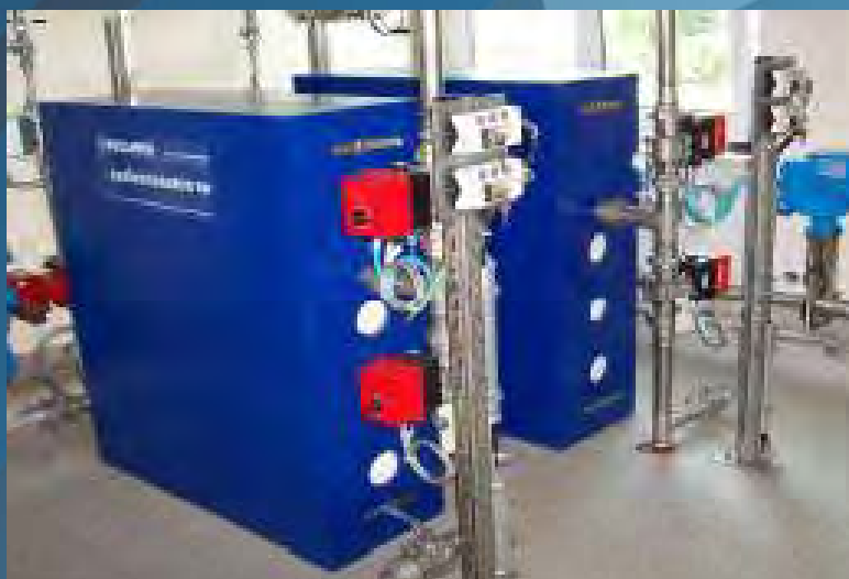
Equipamento instalado na planta de Bamberg (Alemanha)
