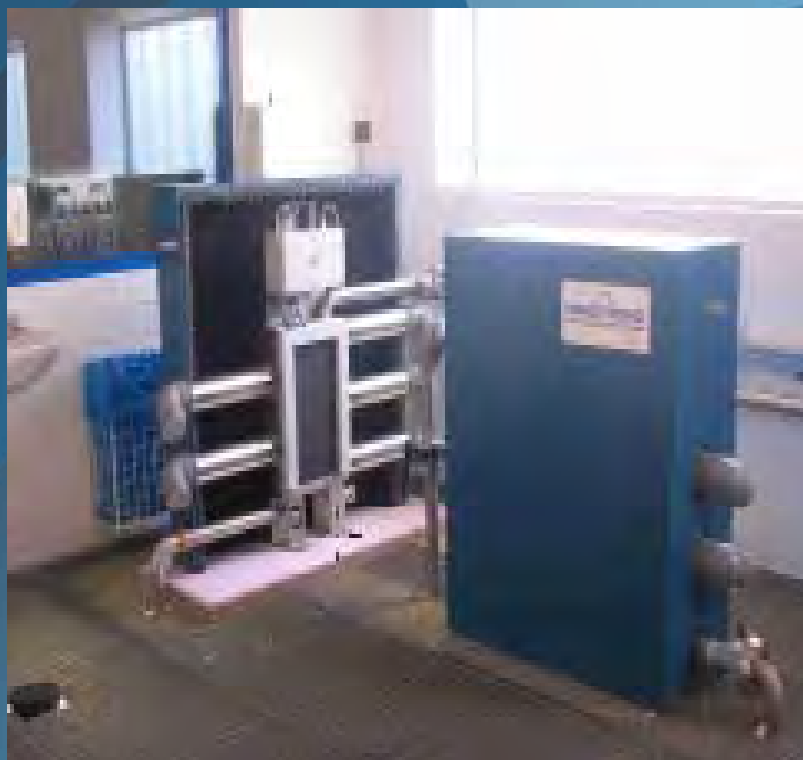
Equipamento instalado na planta de Meldorf (Alemanha)
