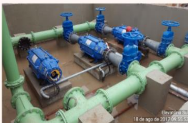
Implantação de 2 EEAT
