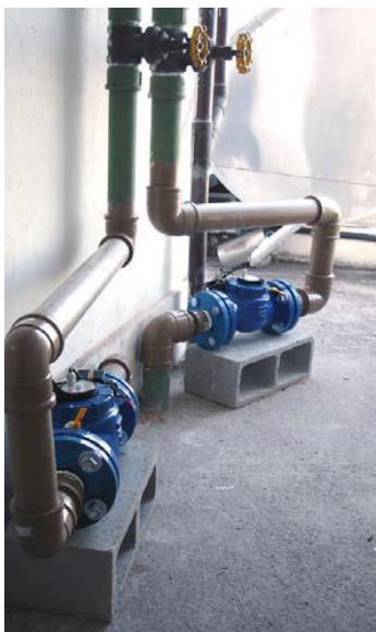
Hidrômetros com saída de sinal
