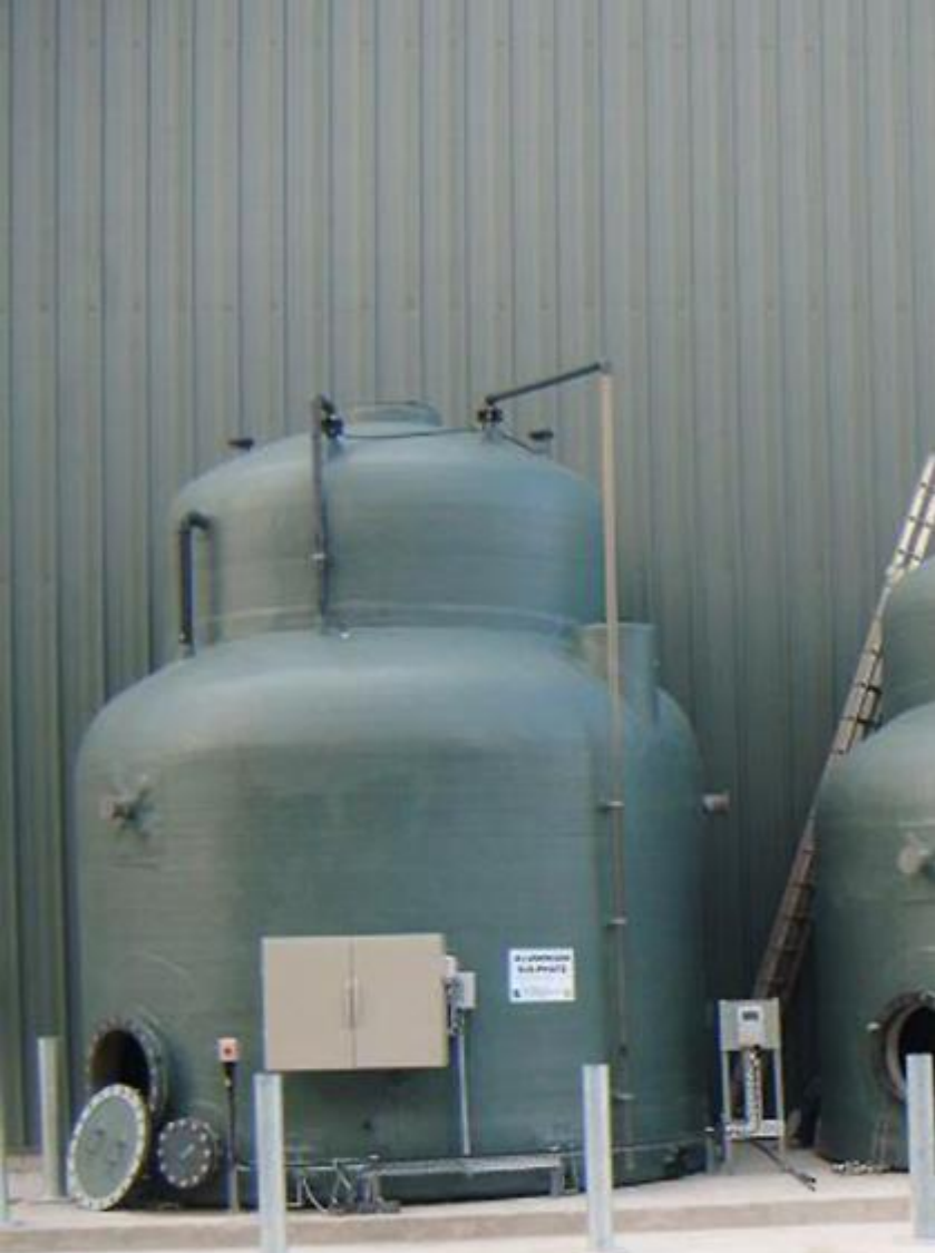
Tanques Produtos Químicos
