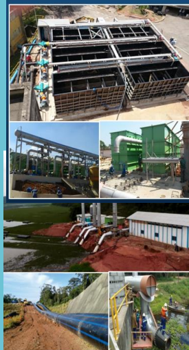
Bombeamento de água entre mananciais de diferentes sistemas.
