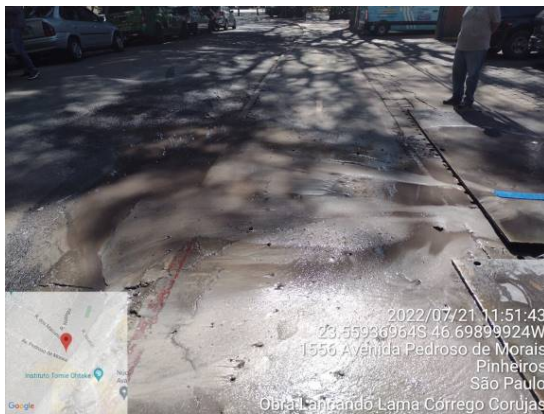
Figura 9 – Local que estava descartando resíduos de obra
