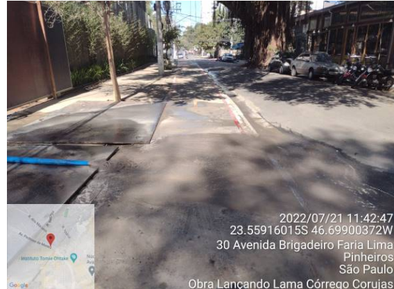
Figura 10 – Local que estava descartando resíduos de obra
