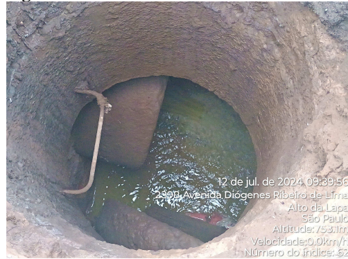
Figura 16 – PV de GAP que confirmou o esgoto
