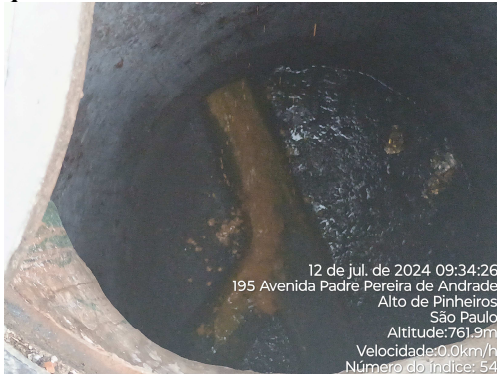
Figura 15 – Poço de Visita (PV) de esgoto que foi teste de corante
