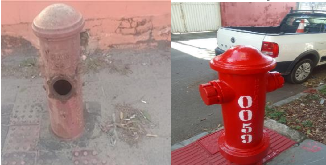
Figura 8: Situação de hidrante identificado na coleta de campo
