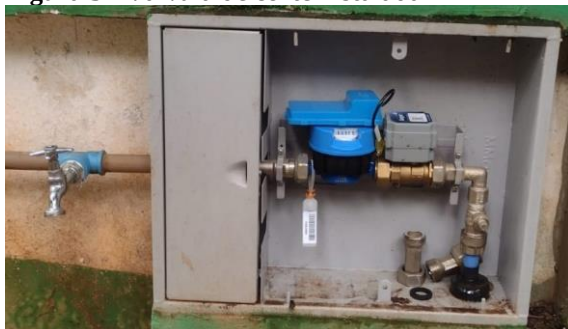
Figura 5 - Válvula de corte instalada
