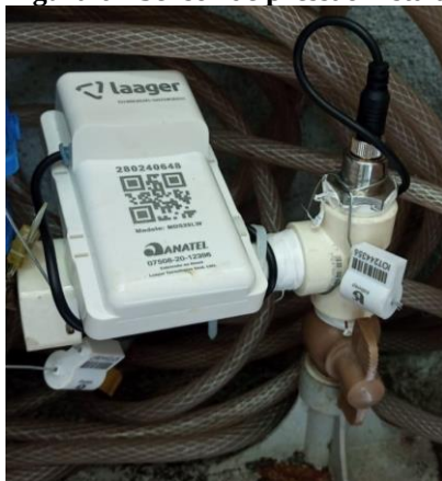
Figura 6 - Sensor de pressão instalado
