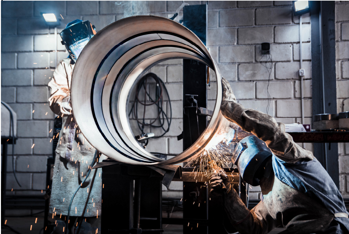
Figura 9 – Demonstração da execução de junta soldada do tipo Butt Strap em tubos DN 700, 6,35 mm de parede.
