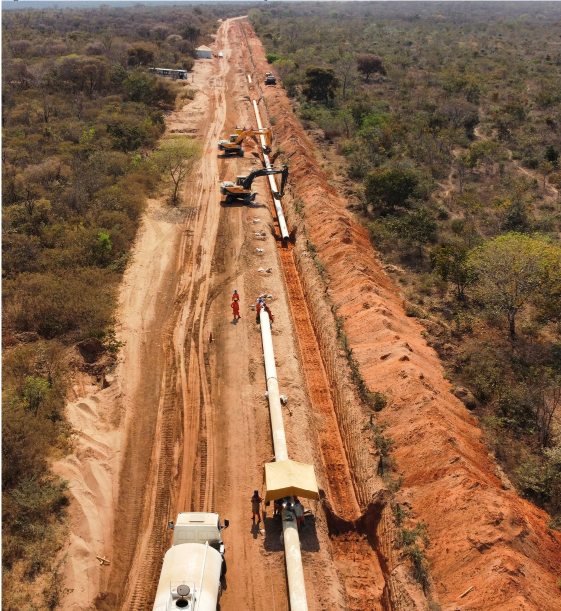
Figura 14 - Vista aérea das atividades de construção da Adutora do Sistema São Francisco.
